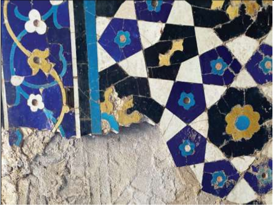
تصویر ۵ جدا شدن پنل‌ها و قطعات کاشی از دیوارها و در برخی موارد فروریختن جزئی آنها، به دلیل آسیب آب به خطوط خوشنویسی و هندسی.
