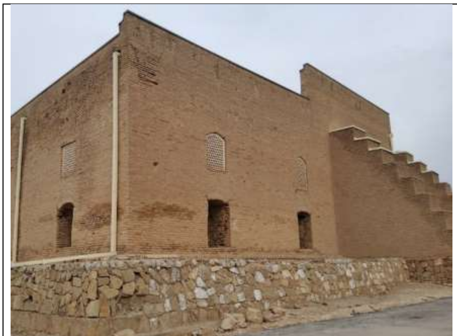
تصویر ۶ نصب سقف فولادی جدید، ناودان‌های با غلاف فولادی و لوله‌های زهکشی به همراه لوله‌های رابط برای انتقال آب از پایه‌های سنگی مسجد.
