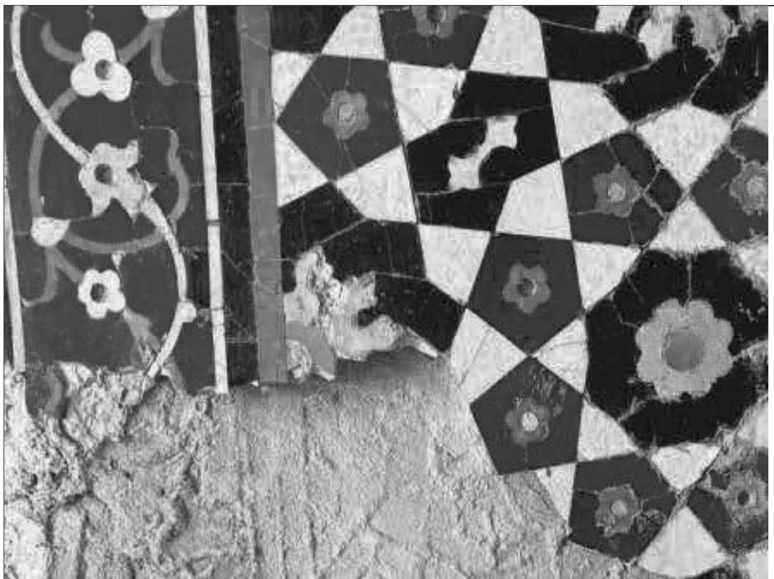
تصویر ۵ جدا شدن پنل‌ها و قطعات کاشی از دیوارها و در برخی موارد فروریختن جزئی آنها، به دلیل آسیب آب به خطوط خوشنویسی و هندسی.
